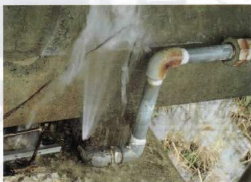
老朽化した水道管の破損状況
