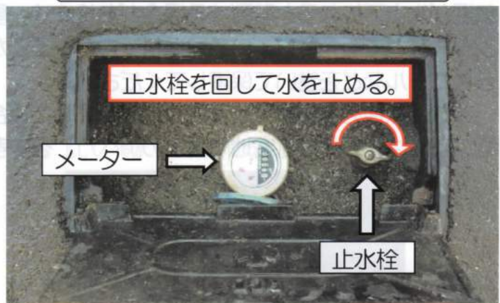
メーターボックス内 (蓋を開けた状態)
